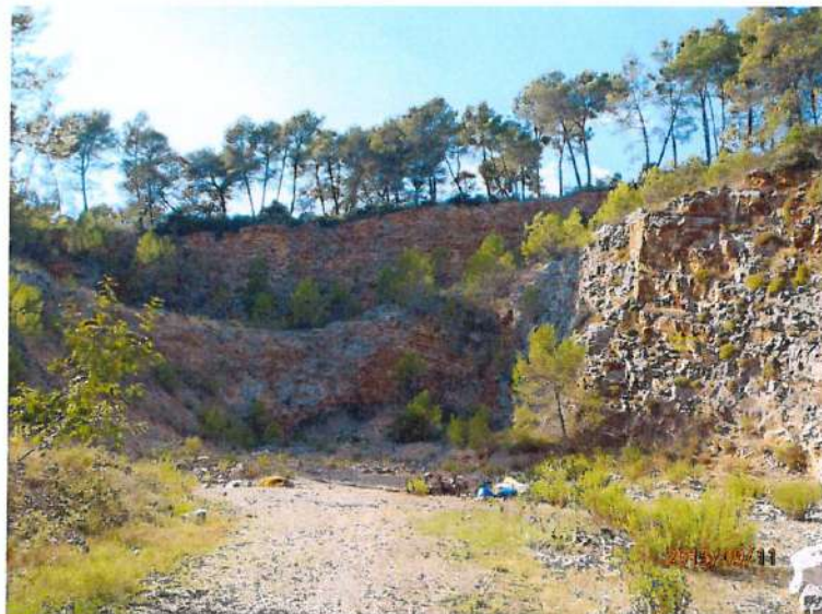
Photo n° 28 : zone à chute de blocs dans le quartier de Peyroue
