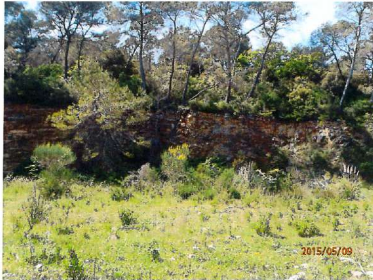
Photo n° 27 : zone à chute de blocs dans le quartier du Grand Vallon
