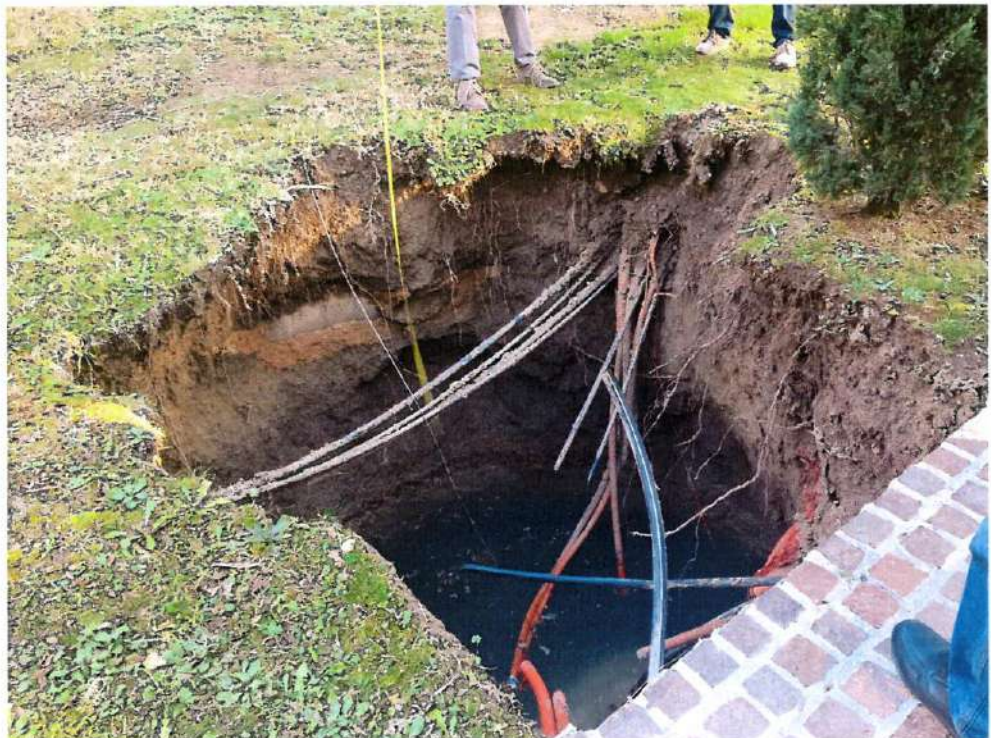
Photo n° 26 : Effondrement constaté en décembre 2017 dans une propriété privée dans le quartier du Val D'Aussel
