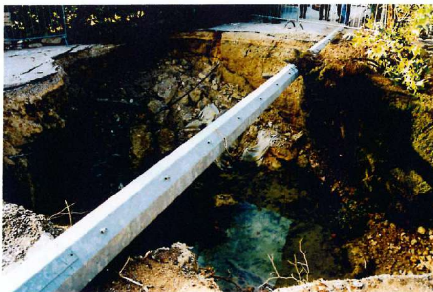
Photo n° 4 : Vue du fontis en 1999-2000 (Photo de M. Bardot)
