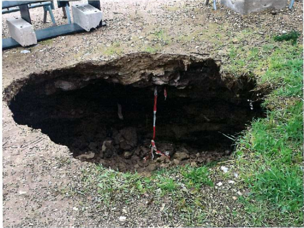
Photo n° 25 : Effondrement constaté en décembre 2017 sur une voie d'accès dans le quartier du Val D'Aussel
