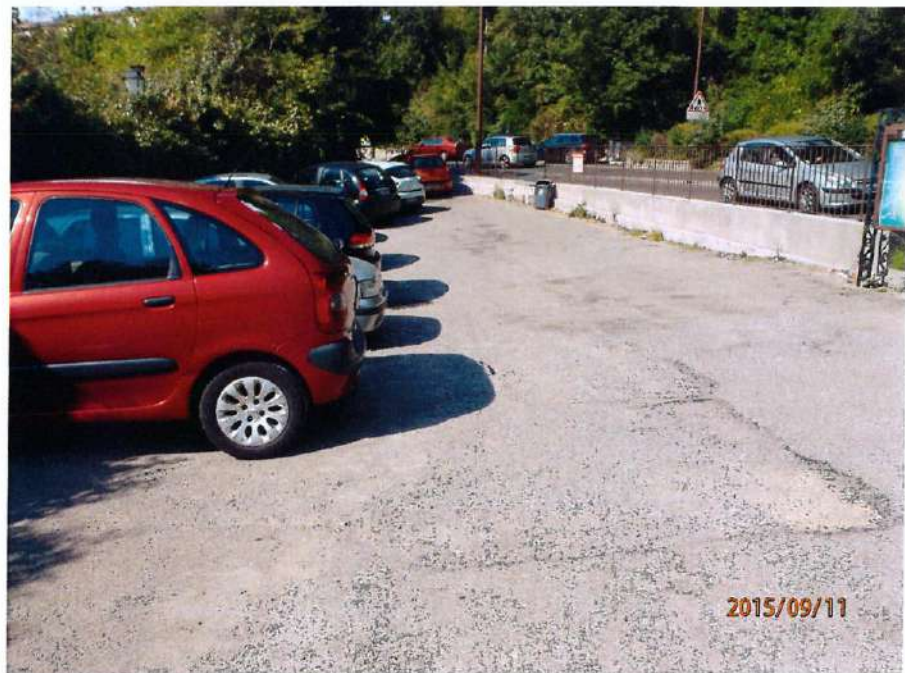
Photo n° 24 : zone affaissée au niveau du parking du Val de Mougins
