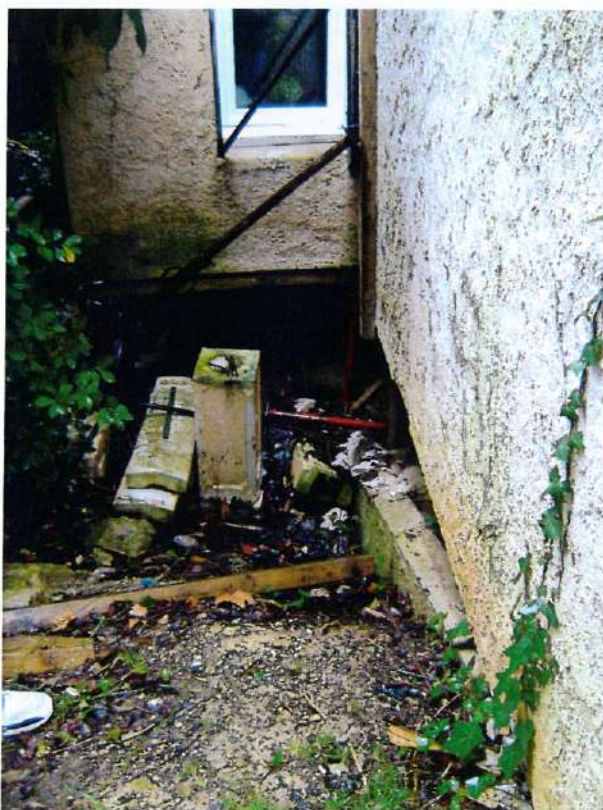
Photo n° 20 : fontis sous une maison dans le quartier du Val d'Aussel
