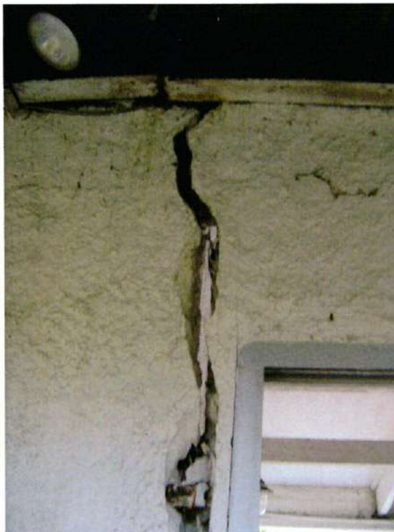
Photo n° 21 : dégâts structurels sur une maison dans le quartier du Val d'Aussel
