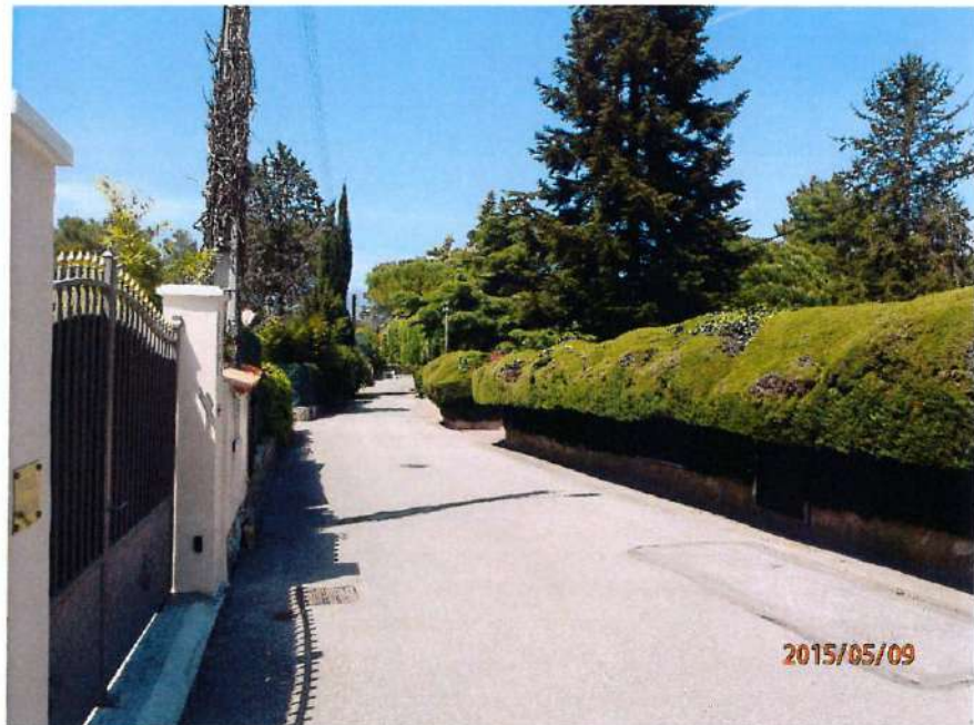
Photo n° 23 : zone en affaissement dans le lotissement les Peyroues
