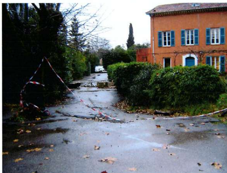
Photo n° 22 : vue de la zone effondrée et en partie rebouchée Bâtiment à droite potentiellement menacé
